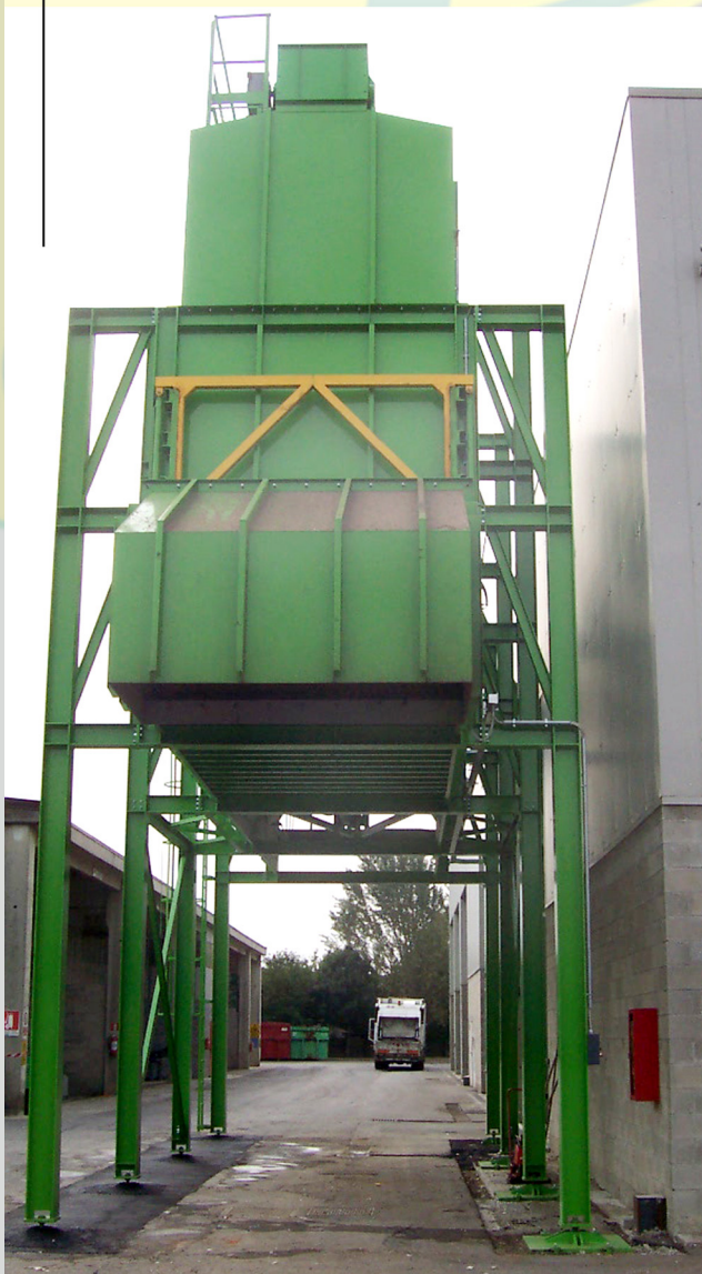
Lato di carico silo gestito da una ghigliottina idraulica
